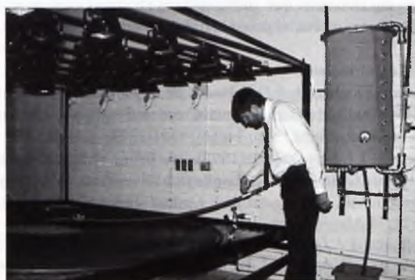
Figuur 3: Son-elektriese warmwaterverhittingstelsel.
